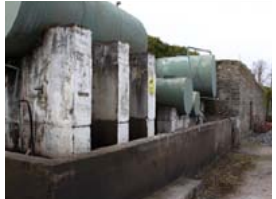
Achten Sie auf eine sichere Lagerung von Kraftstoffen.
