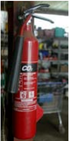
Feuerlöscher müssen griffbereit sein.
