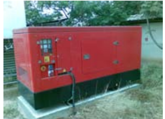
Achten Sie auf den guten Zustand von Generatoren.
