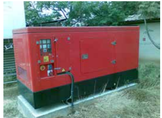
Mențineți generatoarele în stare bună de funcționare.
