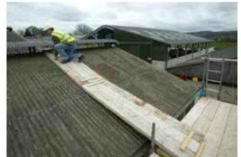
Utilizați panouri pe acoperișurile fragile.
