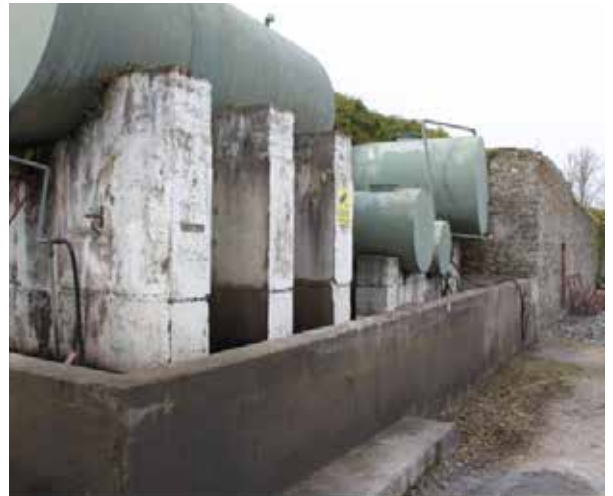
Ke skladování paliva používejte místa se zadržovacími nádržemi.
