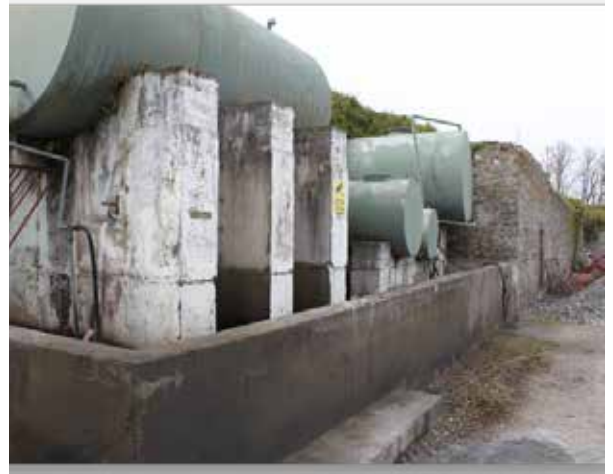
Należy korzystać z zabezpieczonych miejsc do przechowywania paliwa
