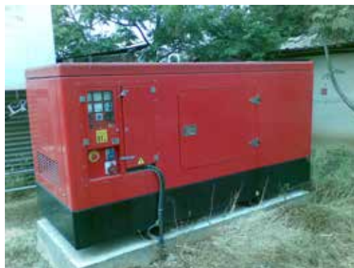
Generatory należy utrzymywać w dobrym stanie
